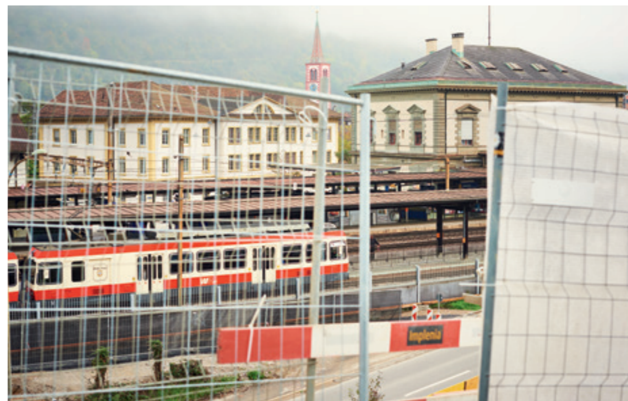
Der Vierspurausbau im Bahnhof Liestal läutet die Bauphase zur Erneuerung der Waldenburgerbahn ein.
