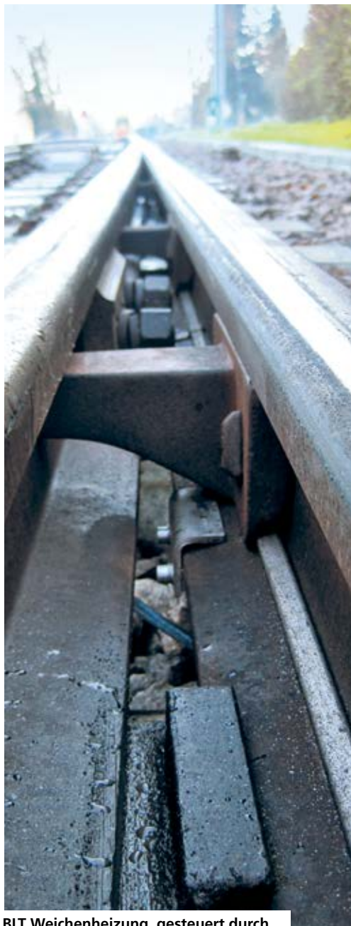
BLT Weichenheizung, gesteuert durch...
